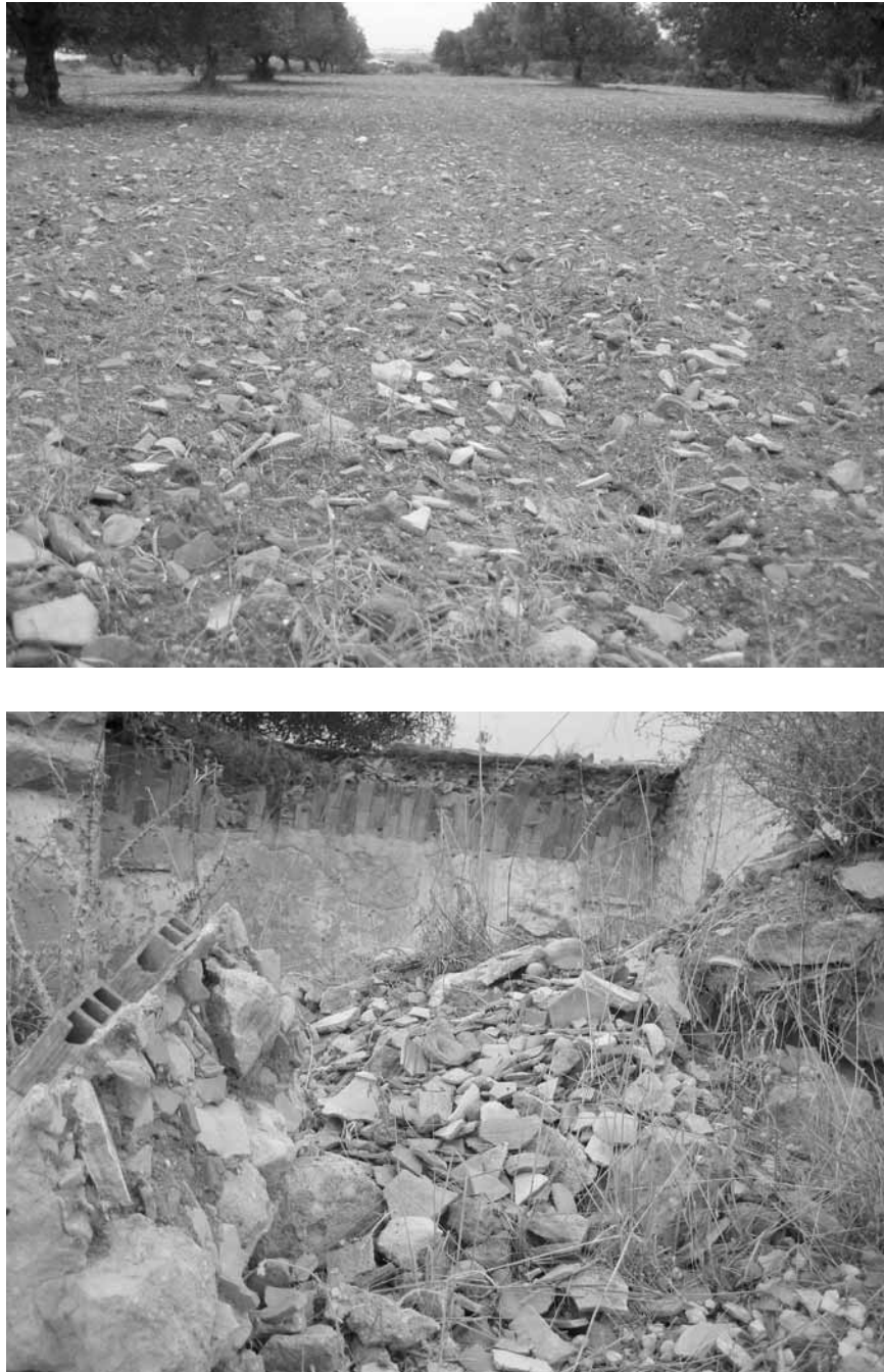
Figure 4.- Sidi Frej, vues du site avec , en bas, la voûte tardive effondrée.
